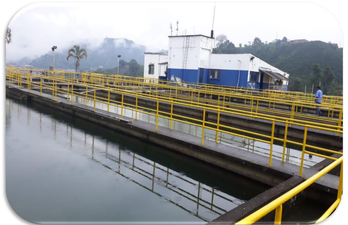
Planta de Tratamiento de Agua Campoalegre
