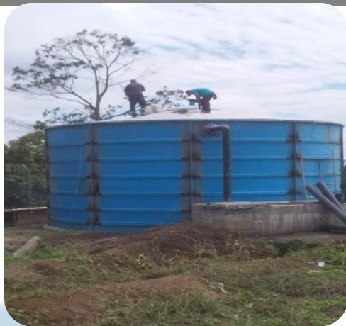
TANQUE DE ALMACENAMIENTO
