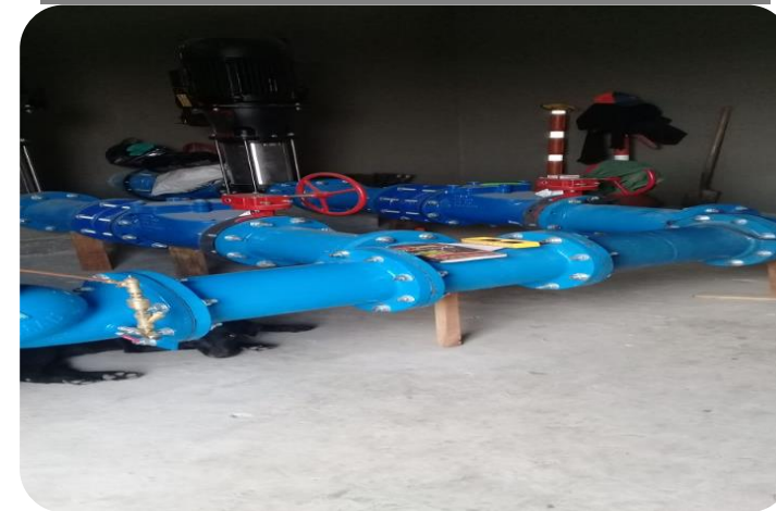
ESTACIÓN DE BOMBEO
